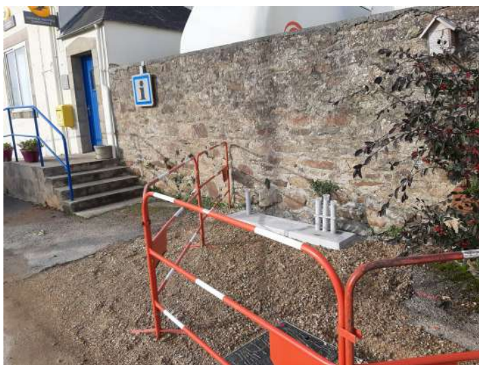
L'armoire de répartition sera installée près de la poste
